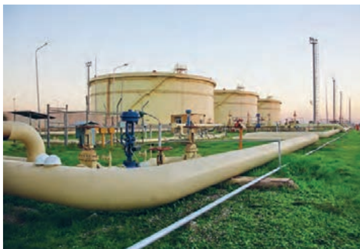
شکل ۲۱- نمایی از خطوط انتقال سوخت
